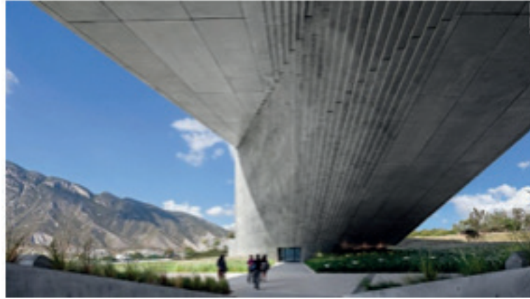
FIGURA 14: Vão no acesso ao Centro Roberto Garza Sada, de Arte, Arquitetura e Design.
