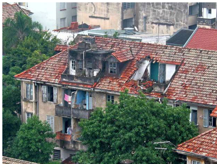
Figura 04: Degradação dos casarios.
